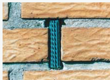
Studsugerør monteret i mur
