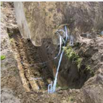
Synlige nettråde ved opgravning
